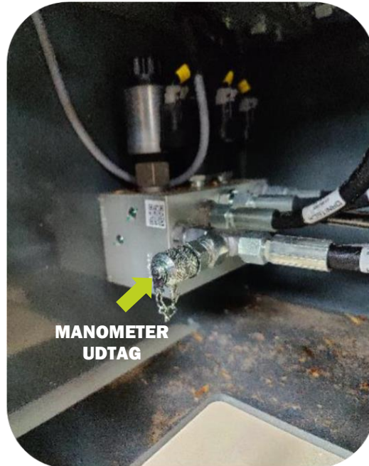
Tilslutning af manometer ved udtag på højtryksfilter
