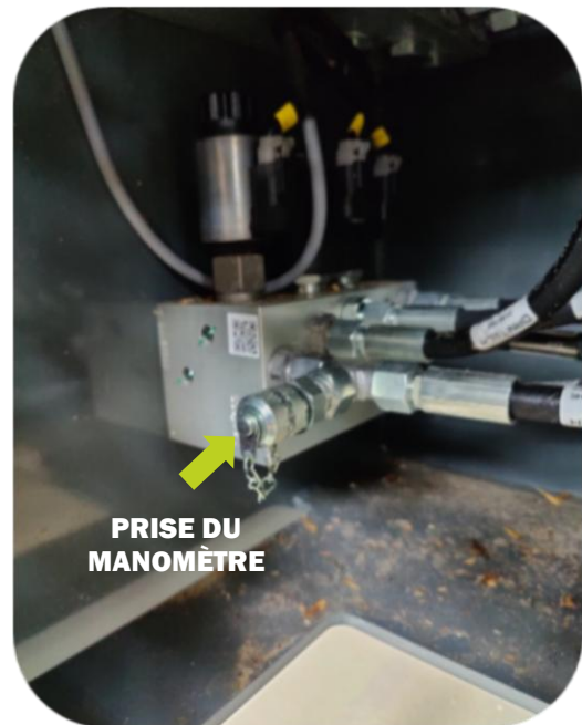
Raccordement d'un manomètre à la sortie du filtre à haute pression
