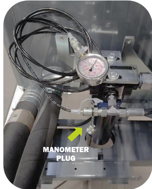
Aansluiting van manometer bij de uitlaat op het hogedrukfilter
